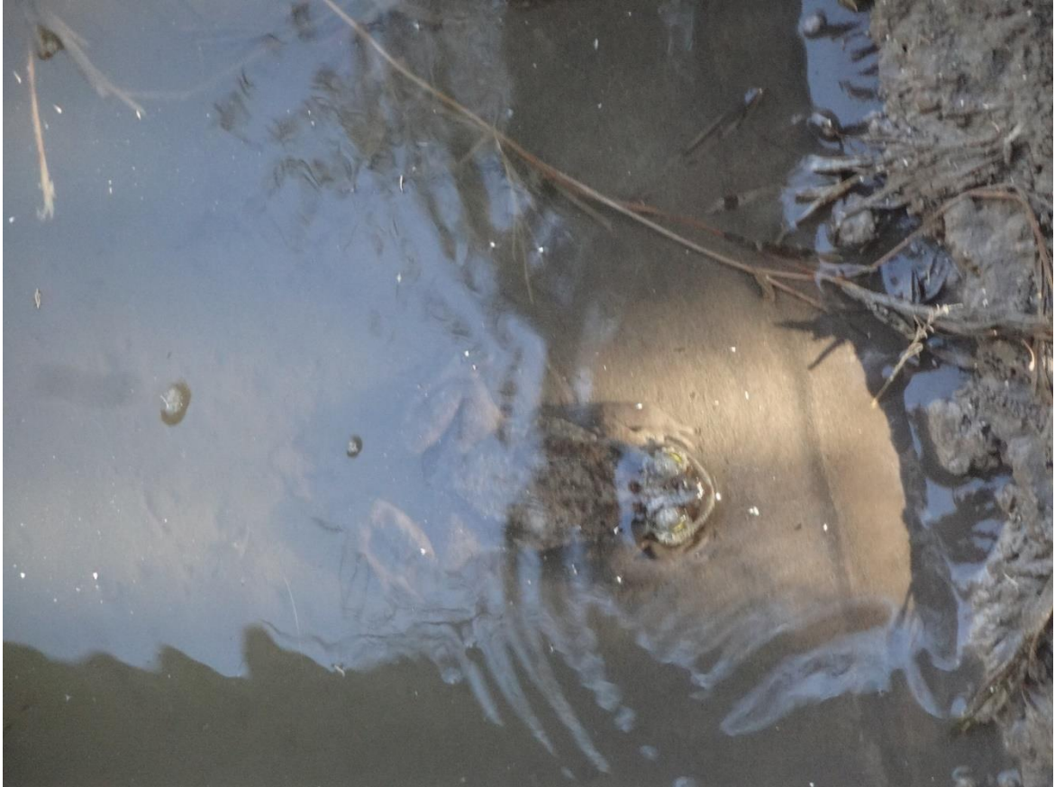
Imagen 24: Fecha de toma: 29-01-2018 / Lugar: Puente La Puntilla / Coordenadas: 36°15'33.45"S; 67°10'42.68"O.
