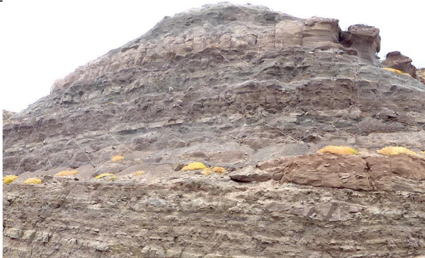
Vista de Malla reforzada con anclajes y cables sobre taludes rocosos.
