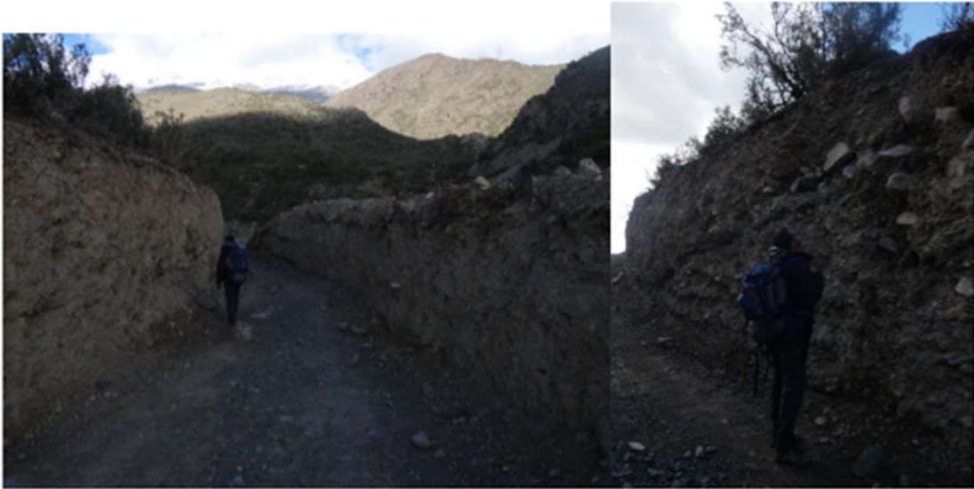
Imagen 4. a y b) camino de acceso al arroyo construido para acceder al sector donde se ubica la obra de toma.
