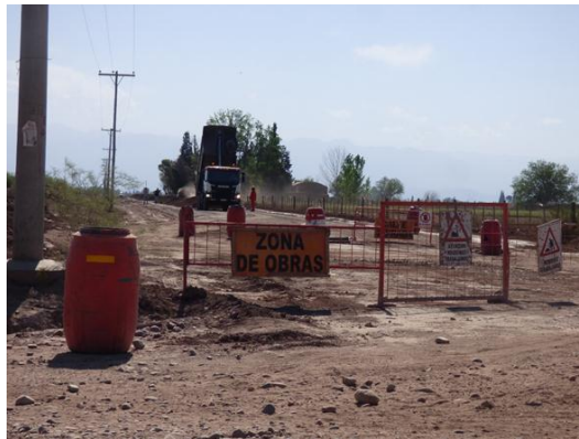
Foto N° 8: Personal y vehículo trabajando sobre calle de ingreso al Establecimiento Depurador El Paramillo. Cartelería de señalización e instrumentos indicadores de cierre de calle 6.
