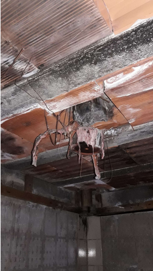
Viguetas y losetas deterioradas.
