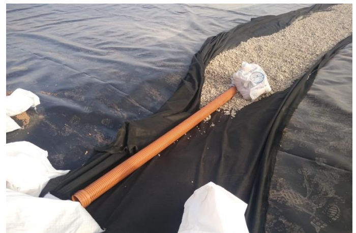
Fig.5.d – Cobertura del conducto colector de fugas.
