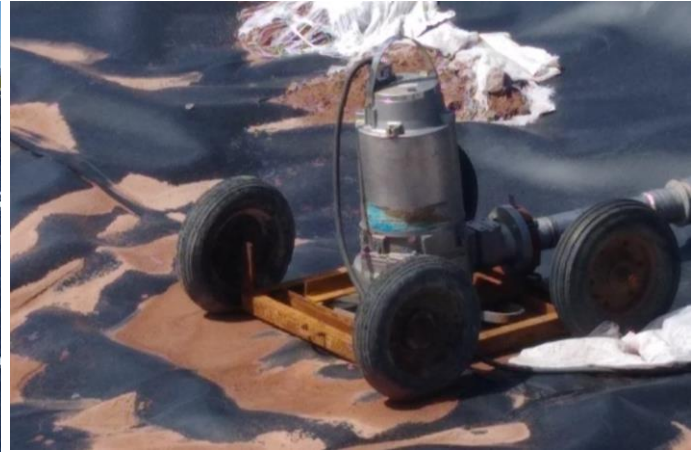
Fig.9.b – Bomba sumergible en Dique DN5-Pulmón
