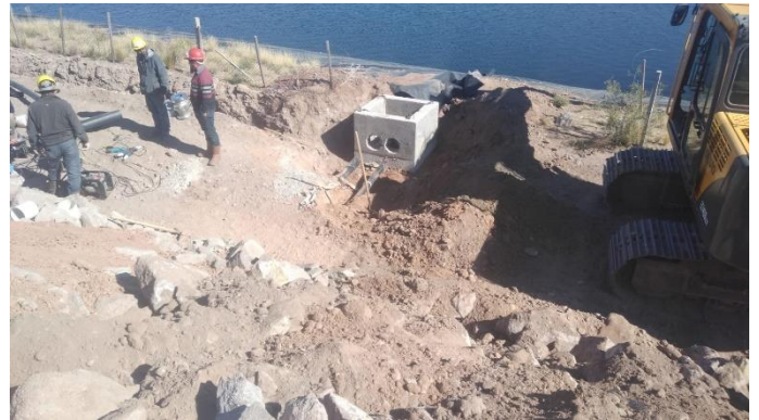
Fig.8.b – Caseta de bombeo.
