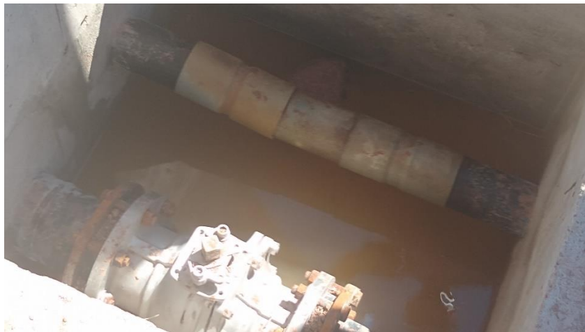
Fig.9.e – Válvulas y medición de caudal
