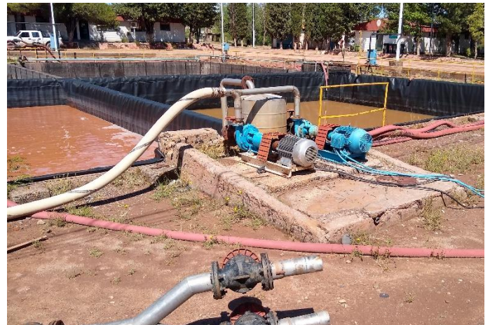
Fig.9.g – Equipo de Bombeo en Cisterna 3.
