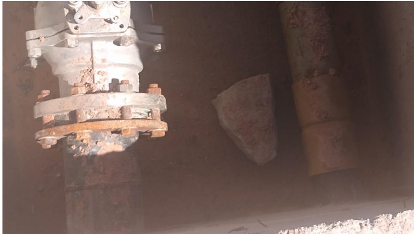
Fig.9.d – Válvula de salida Dique DN5-5 y tubo de infiltración intermembranas.
