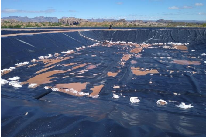
Fig.9.a – Ingreso del agua al Dique DN5-Pulmón
