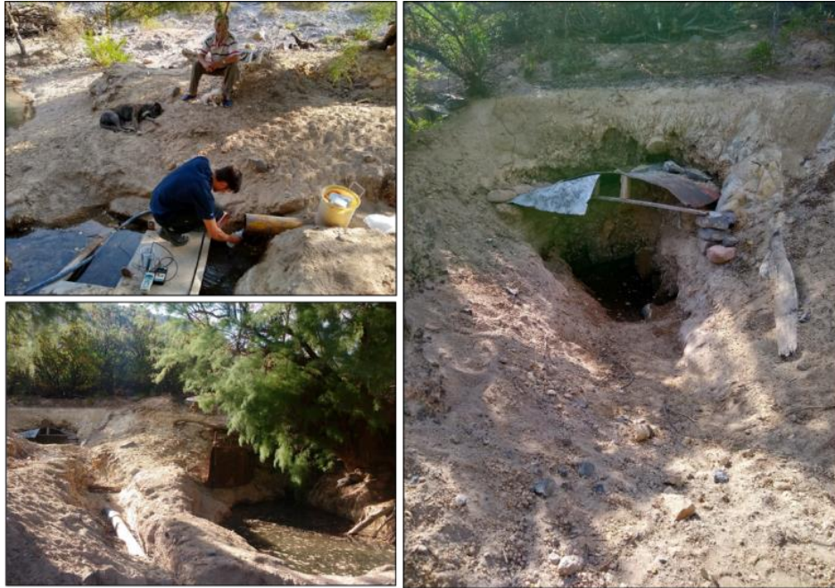
Fotografía 6 – Captación sitio PM1 “Puesto Jorge René Flores”.
