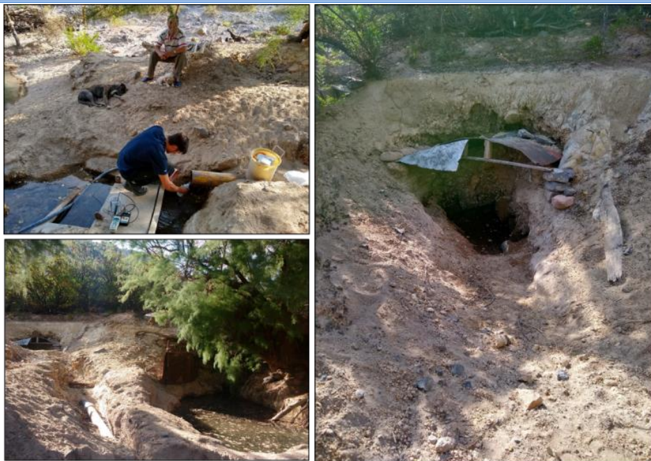
Fotografía 6 – Captación sitio PM1 “Puesto Jorge René Flores”.
