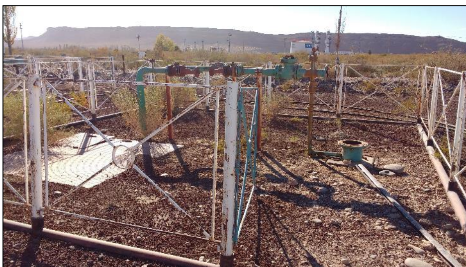
Fotografía 3 – Pozo de captación de agua (sitio PM15).
