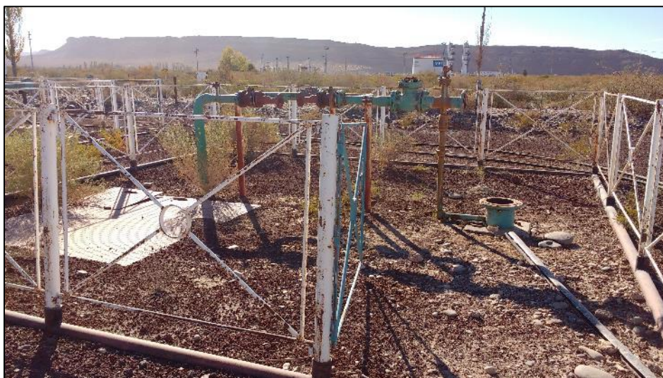
Fotografía 3 – Pozo de captación de agua (sitio PM15).
