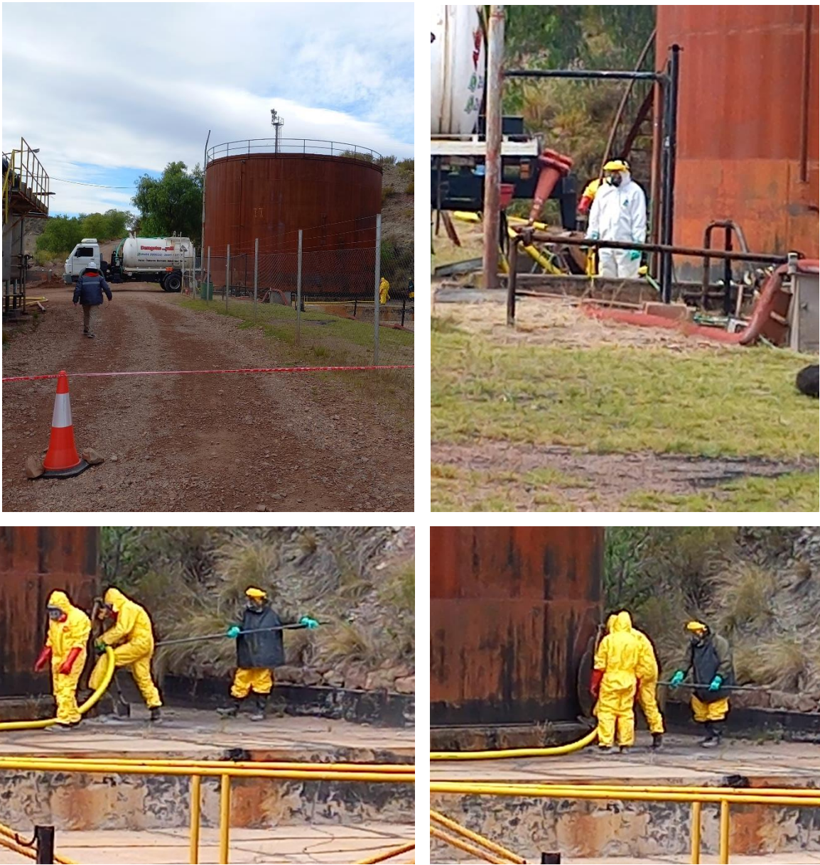
Fig. 3 – Área de Tanques – Proceso de Extracción de Cenizas.
