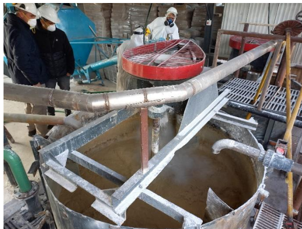
Fig. 6 – Tanque de Neutralización N°2.
