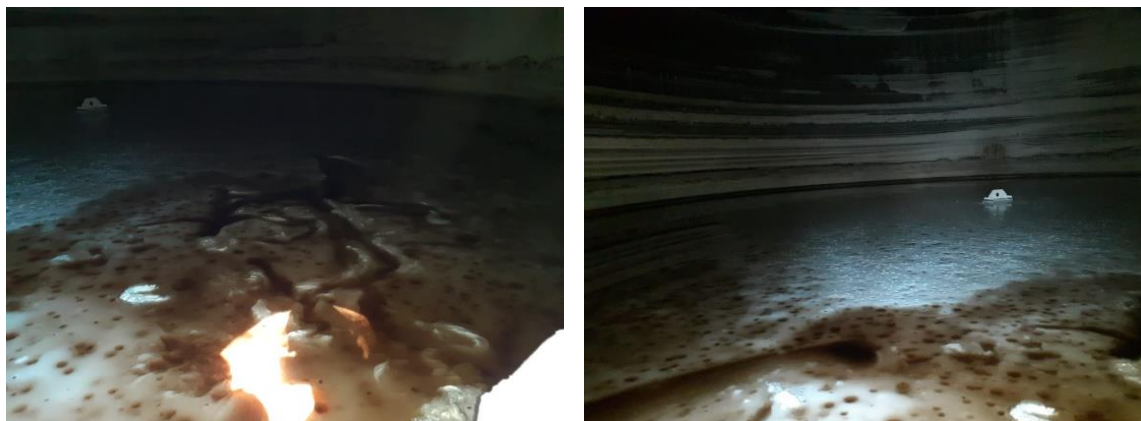
Fig. 1 – Depósito de sedimentos en el Tanque II luego del proceso de trasvase del Ácido Sulfúrico.
