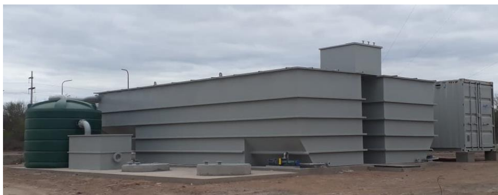
Figura N° 2 Módulos de Tratamiento Biológico
