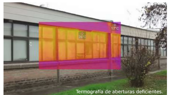
Termografía de aberturas deficientes.
