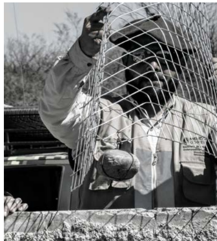
Figura n° 2: Colocación de material pesado en el extremo inferior de la rampa de rescate, para evitar su movimiento o flotabilidad indeseada.
